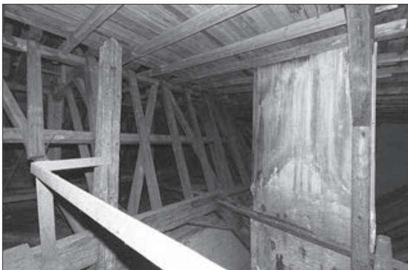
A funkció nélkül maradt függesztőoszlop és kémény a barokk fióktető lenyomatával. (Fotó: Hack Róbert)
